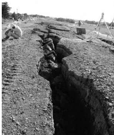
【被災後の鳴瀬川堤防】
