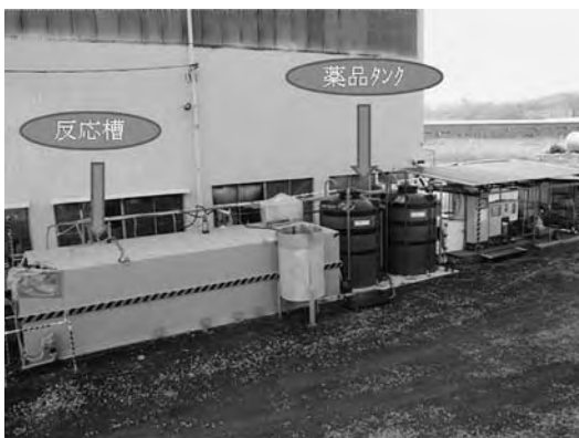
(写真3) フッ素固定化処理装置全景
