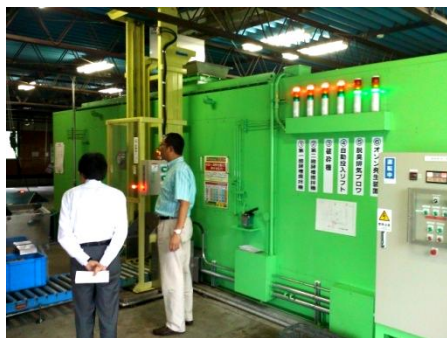
NEWクリーンバイザー (無限ファクトリーに設置)
