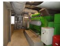
LNG利用のトリジェネ (暖房熱、発電、CO 2 施用)
